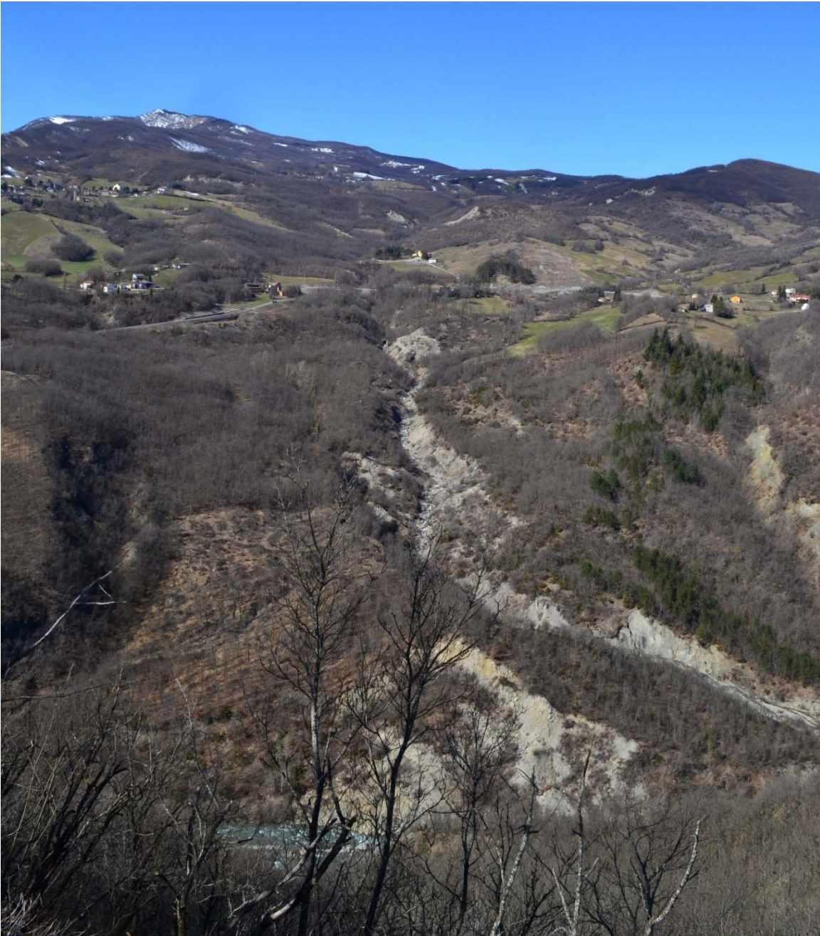
Fig. 8 - Il piede della grande frana di Lalatta in corrispondenza dell'alveo del Torrente Enza. Il deposito di frana quiescente appare profondamente inciso dalle acque del Rio Rumieto.
